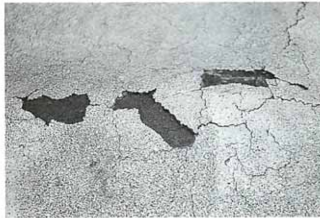
防水層の破断状況
