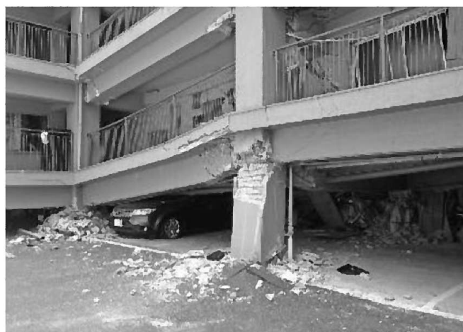
【写真-1】 熊本地震でピロティが圧壊した民間マンション
