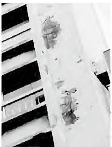
爆裂（鉄筋が露出）
