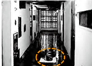
天井からの水漏れ
