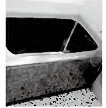
浴槽のまたぎが高い ◆転倒の懸念 ※実際に骨折事故が発生
