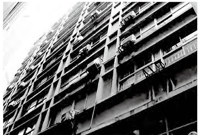
バルコニーがなく、二方向避難ができない
