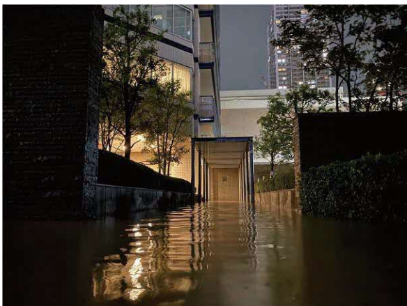
台風により冠水したマンションの敷地 国土交通省／経済産業省 「建築物における電気設備の浸水対策ガイドライン」より
