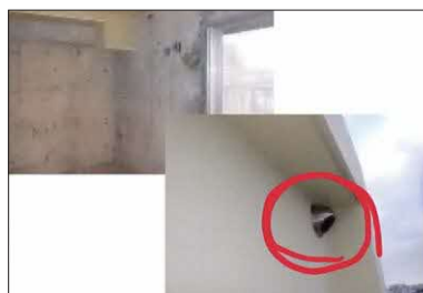
【図1】区分所有者の独断で外壁を壊し、エアコンスリーブを開通
