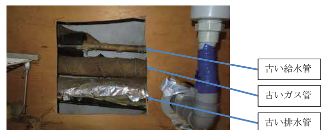
【図5】錆びた鉄製の水道管が交換されていない
