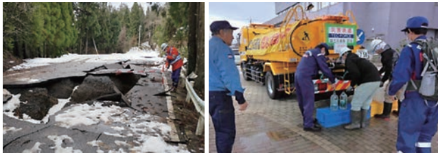
輪島市：道路被災調査
