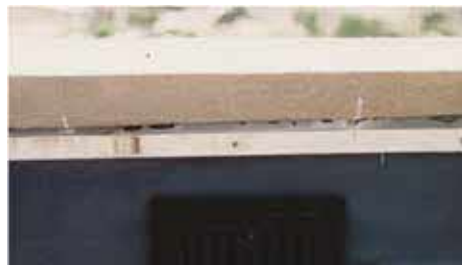
押さえ金具のシーリングの切れ
