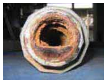
接続部の腐食（錆）
