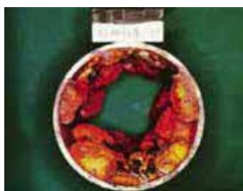
管内部の腐食
