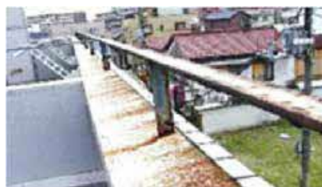
手すりの腐食
