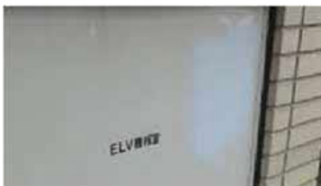
塗膜表面の劣化（変退色）
