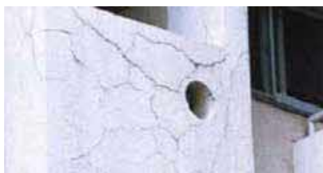
躯体のひび割れ
