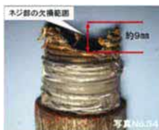
接続部の欠損
