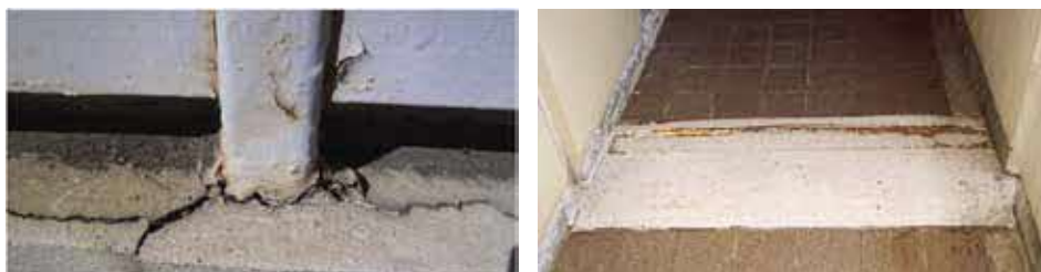
塗装の膨れと支柱付け根のひび割れ エキスパンションジョイントの腐食
