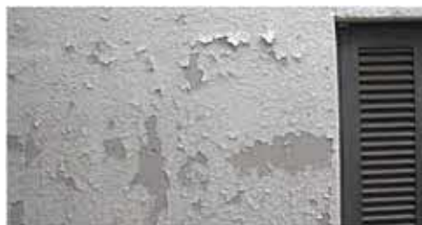
塗装の剥がれ
