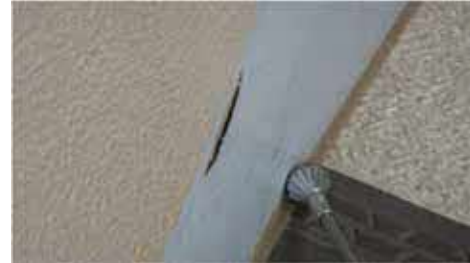
防水層の破断
