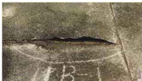
防水層接合部の剥がれ
