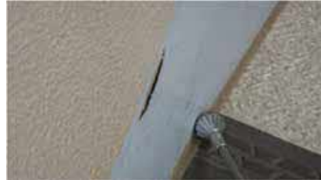
防水層の破断
