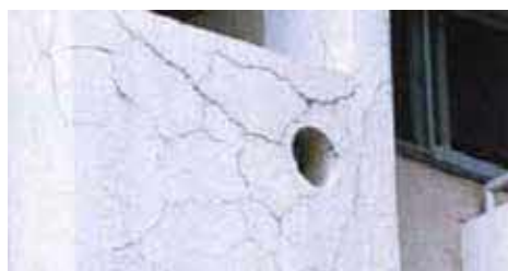
躯体のひび割れ
