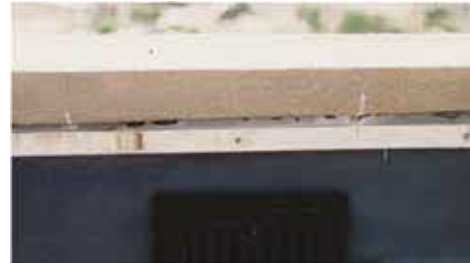
押さえ金具のシーリングの切れ
