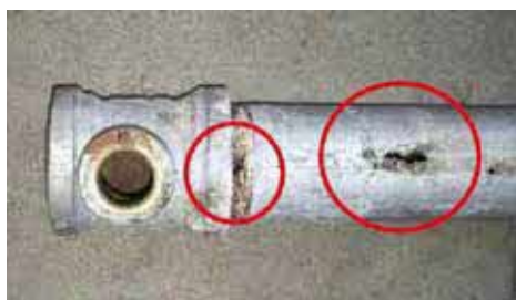
排水管外部の腐食（錆と漏水跡）
