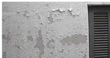
塗装の剥がれ
