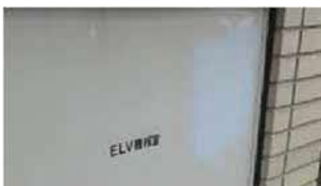
塗膜表面の劣化（変退色）
