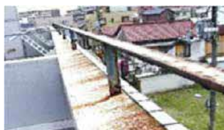
手すりの腐食
