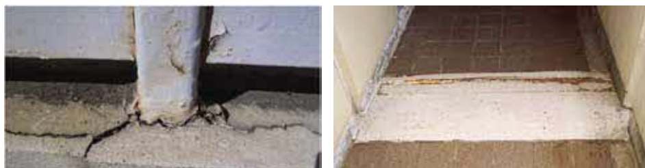
塗装の膨れと支柱付け根のひび割れ エキスパンションジョイントの腐食
