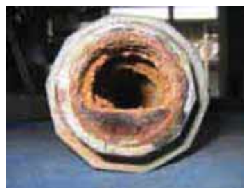
接続部の腐食（錆）
