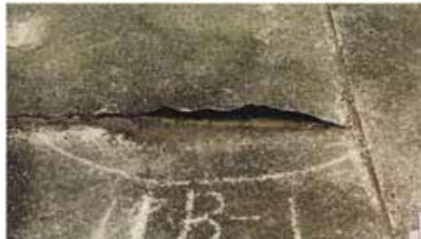
防水層接合部の剥がれ
